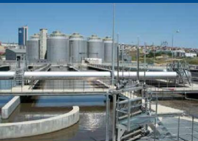
Image d'un bassin de boues activées et digesteurs.
