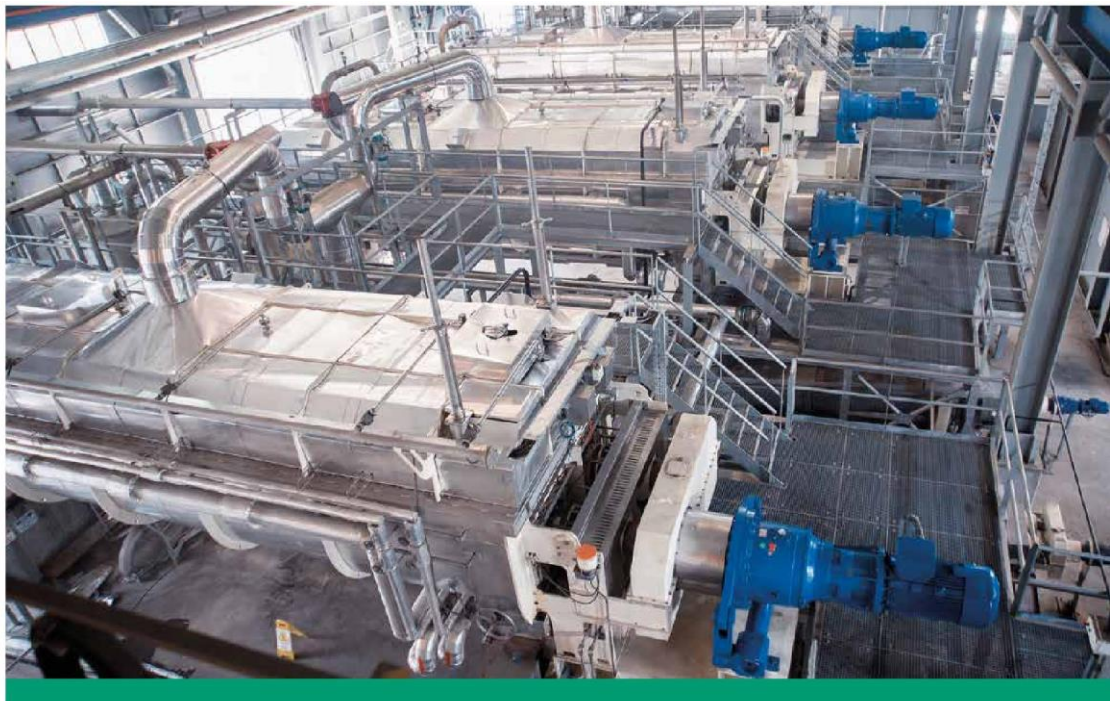
Unités de Séchage des boues
