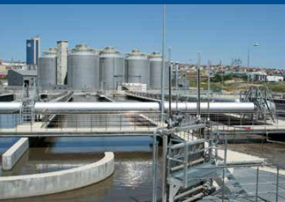
Belebung und Faulung
